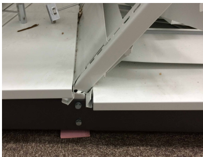
移動棚の支柱脚部 自立棚用に開けていたボルト穴に荷重が集中し座屈した
