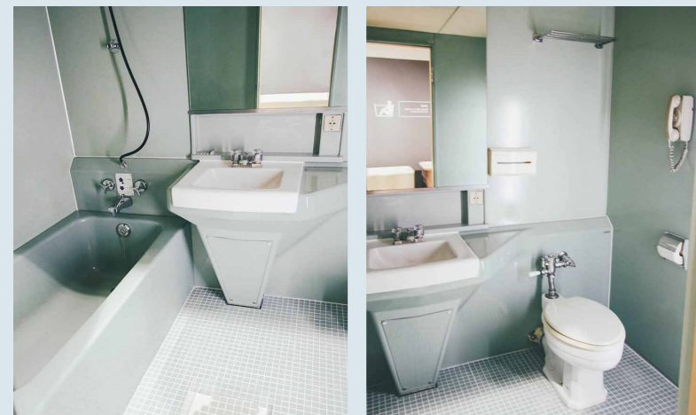
山崎さんの思い出のあるユニットバスルーム ホテルニューオータニに納入した初代モデルで平成28年(2016)に(一社)建築設備技術者協会より「建築設備技術遺産」に認定された
